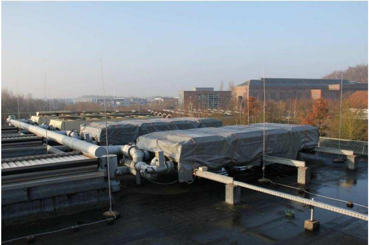
Notkühler auf BHKW Dach
