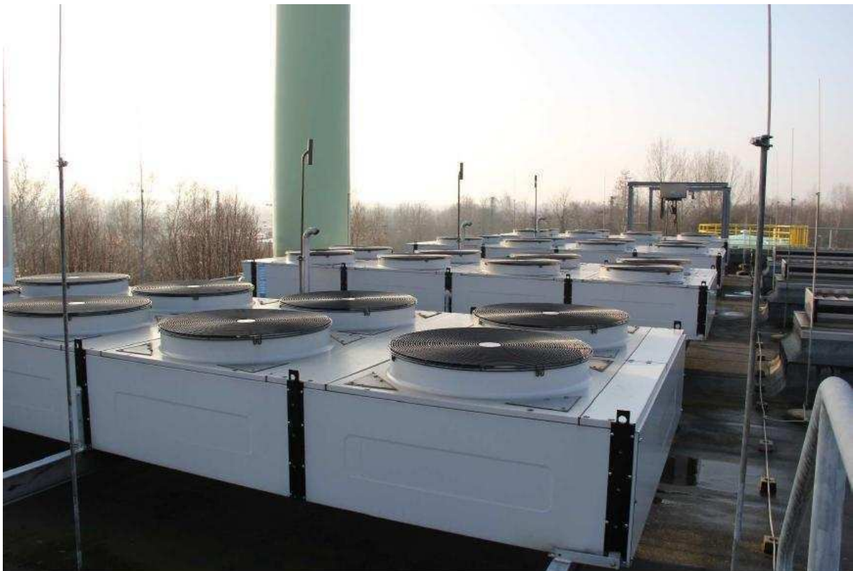
Gemischkühler auf BHKW Dach
